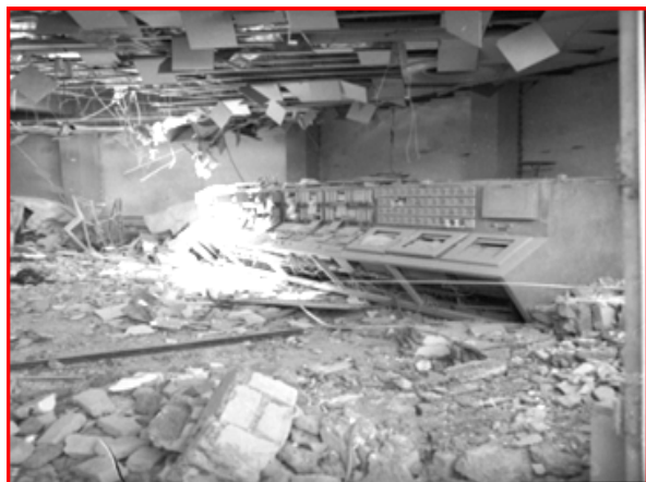
شکل ۱- ساختمان کنترل منهدم شده پالایشگاه شیراز [۳۳]
