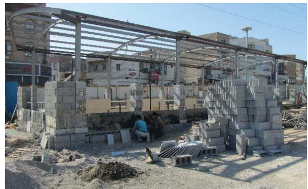
شکل ۵- سیستم سازه‌ای سطحی و طول نامناسب سازه ورودی ایستگاه دروازه
