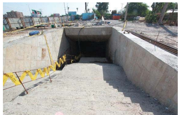
شکل ۶- سیستم سازه‌ای زیرسطحی و طول نامناسب سازه ورودی ایستگاه فرودگاه
