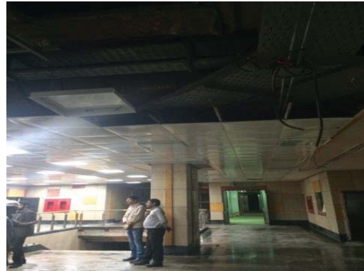
شکل ۸- تاسیسات زیر سقف و سقف کاذب ایستگاه دروازه
