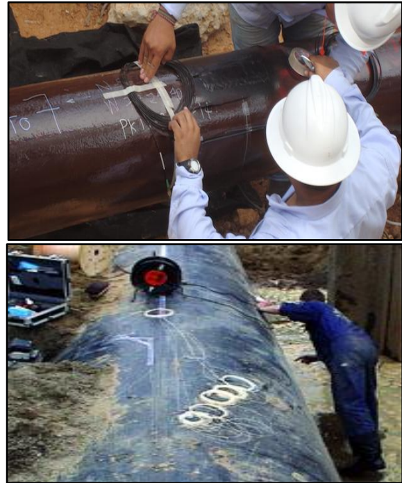
شکل (۹): استفاده از حسگر \Phi -OTDR در لوله‌های انتقال انرژی برای شناسایی محل شکستگی یا ترک خوردگی [۵۴].
