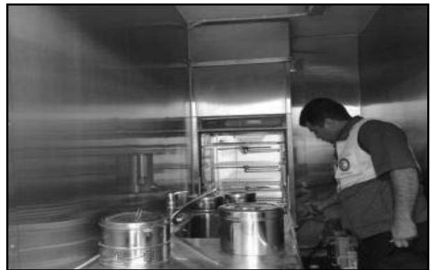
شکل ۶- نمای داخلی کانکس استریلیزاسیون (C.S.R) به‌صورت آماده [۱۴]
